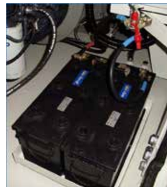
Figura 18 - Desconectador de baterías
