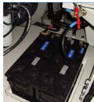
Figure 18 – coupe courant des batteries
