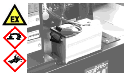
Bateria de alimentação: perigo de corrosão, explosão.
