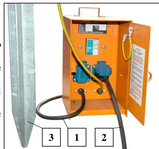
Fig. 17 quadro eléctrico de estaleiro
