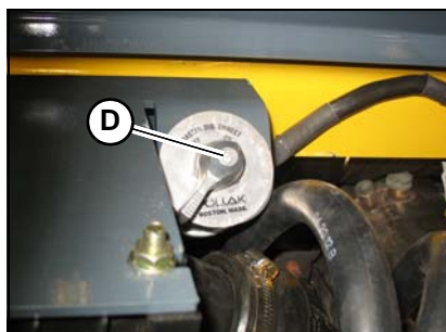
Figura 42 – Interruptor de desligação da bateria
